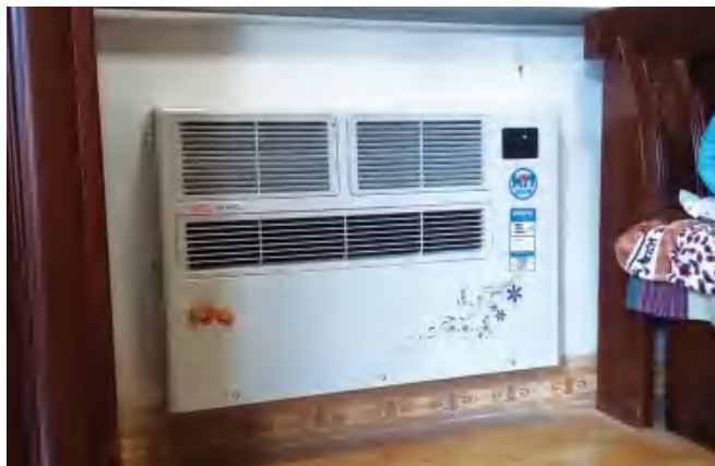
Рис.18 Внутренний геотермальный радиатор ThermoPro, установленный в доме
