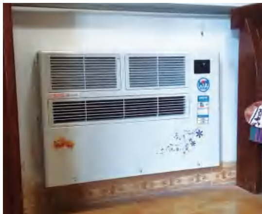
图 18 安装在屋内的地能热宝室内散热器
