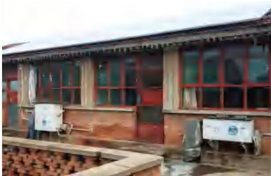
Рис.19 Наружная установка геотермальной энергии, установленная перед домом
