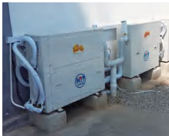
Рис.17 Наружный блок геотермальной установки ТермоПауэр, установленный в задней части дома
