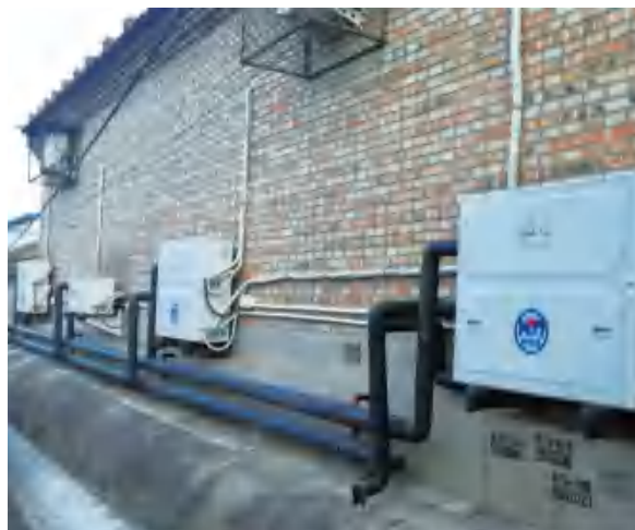
Рис.16 Наружный блок геотермальной установки ThermoPower, установленный в задней части дома
