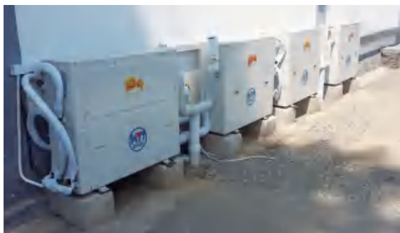
图 17 安装在屋后的地能热宝室外机
