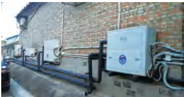
图 16 安装在屋后的地能热宝室外机
