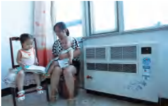
村民家中新安装的地能热宝室内机
