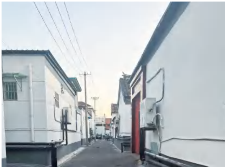
西闸村安装在外墙的地能热宝室外机
