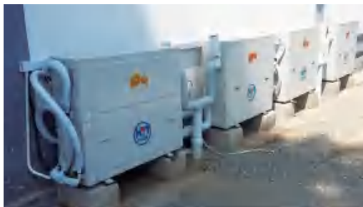
安装在外墙的地能热宝室外机
