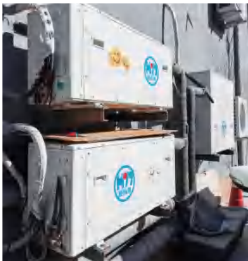
留民营村安装在外墙的地能热宝室外机
