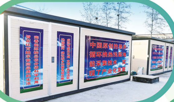
高效電替煤集中供暖機房
