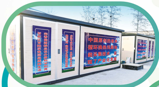
高效電替煤集中供暖機房
