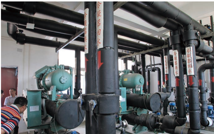
金家林总部基地地能热泵环境系统机房
